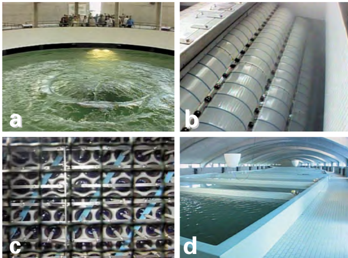
Bodensee- Wasserversorgung auf dem Sipplinger Berg
